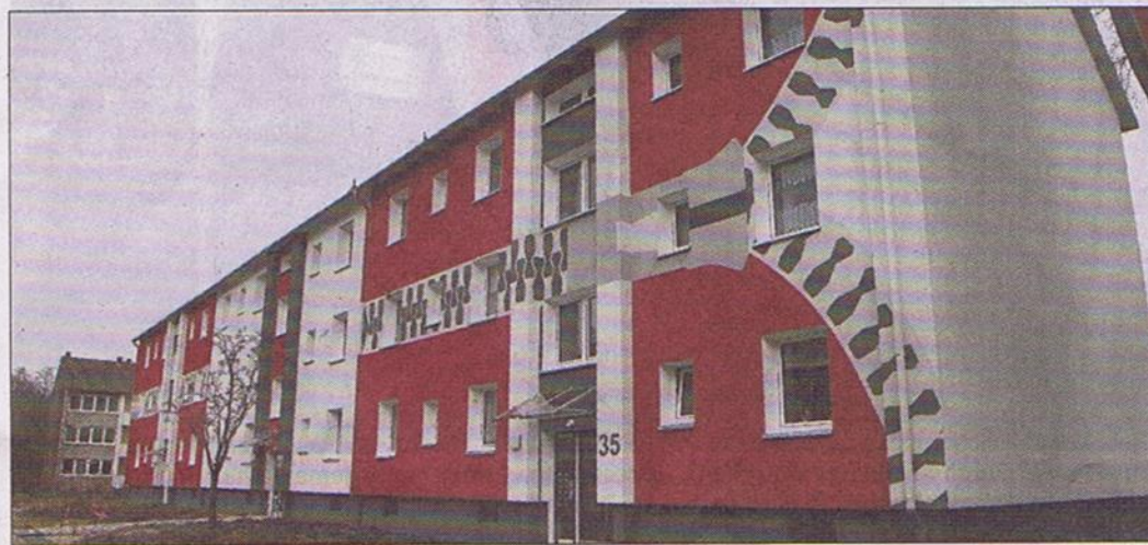
In aufwendiger Handarbeit wurde nach der energetischen Sanierung des Hauses am Klappgarten in Munster auch die Fassade neu gestaltet. Foto: at
